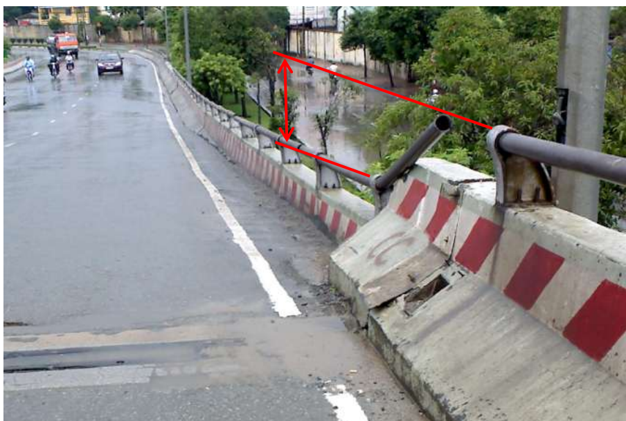
Hình 1.14. Lún lệch tại đường dẫn cầu vượt Tân Cảng (Tp. HCM)
